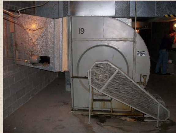
REPLACE AUDITORIUM AHU
